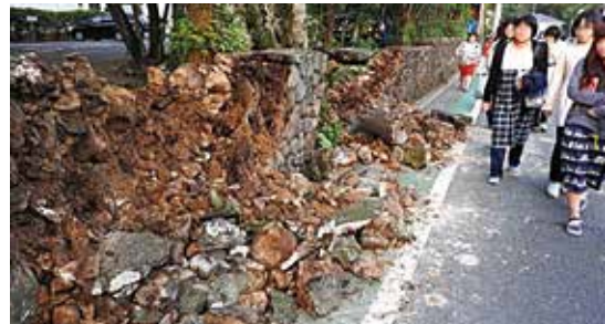
石垣キャンパス正門の石垣が崩壊
